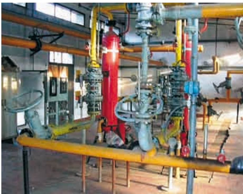
Un impianto di riduzione della pressione primo salto (sarà realizzato a Ossenigo).
