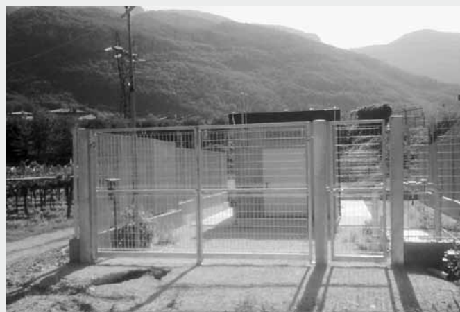
La cabina del metano di Ossengo.
